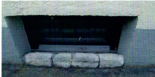
Bild 5: Einfache Schutzmaßnahme am Kellerfenster
