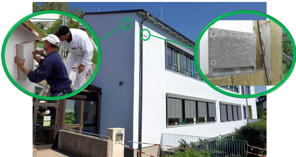
Schule Parsdorf: Links oben, neben dem Fallrohr ein isoliertes Fledermaus-Ganzjahresquartier. Rechts neben dem Fallrohr ein Fledermaussommerquartier. Günstig ist die Anbringung im Bereich von Gebäudeecken, sodass die Tiere für Verfolger unsichtbar „ums Eck“ verschwinden und gleich einfliegen können. Der Luftraum unterhalb des Einfluglochs muss von Ästen und anderen Hindernissen freigehalten werden, damit die Tiere ungehindert an- und abfliegen können.
